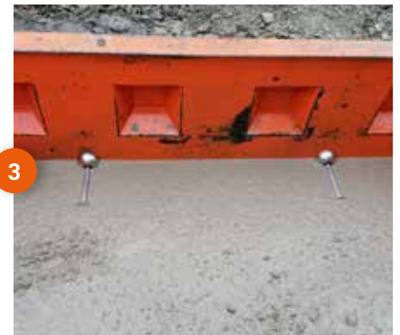
3 L'ancoraggio viene fissato all'interno del magnete, fare attenzione a vibrare il calcestruzzo
